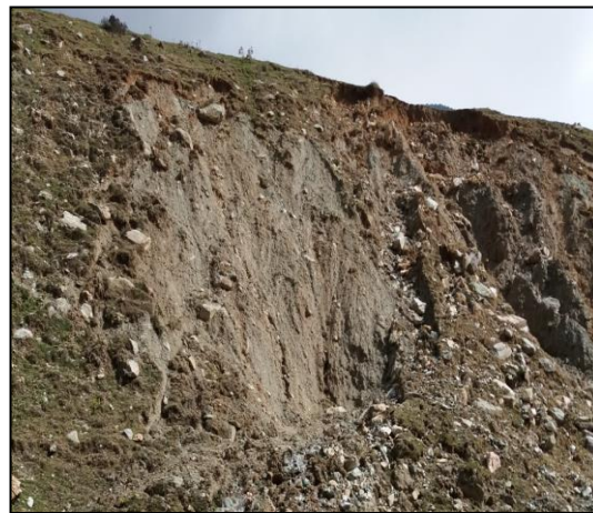
Εικόνα 9. Ολισθήσεις στο κατάντη πρανές.
