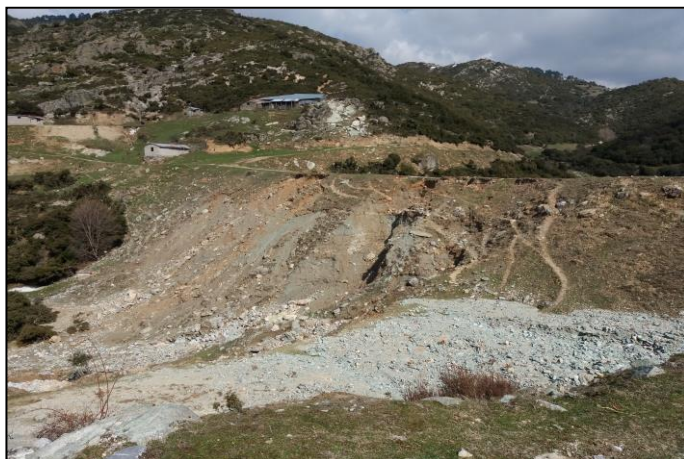
Εικόνα 4. Το διαβρωμένο κατάντη πρανές, μετά την υπερπήδηση του φράγματος.
