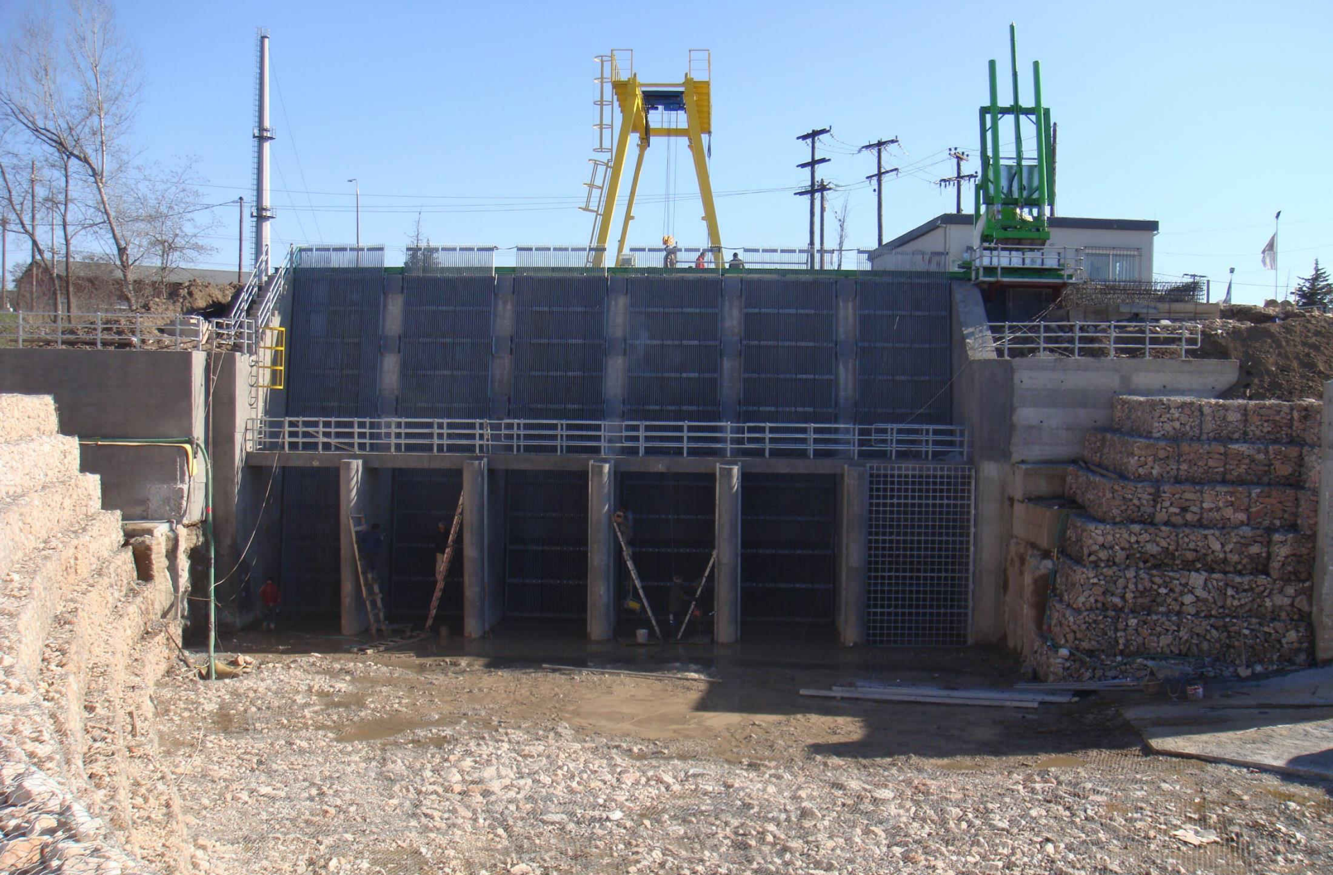
ΑΝΤΛΙΟΣΤΑΣΙΟ ΚΑΡΛΑΣ ΣΤΟΝ ΠΗΝΕΙΟ Pumping station Peneus
